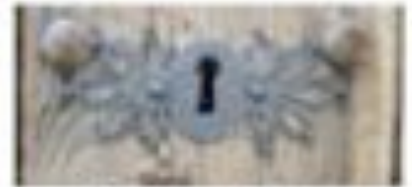
Réalisation par des clés forgées, certains traversent et sont reliés à l'intérieur
